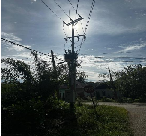
Gambar 4. 6 Transformator Sisipan GD 630 FD
