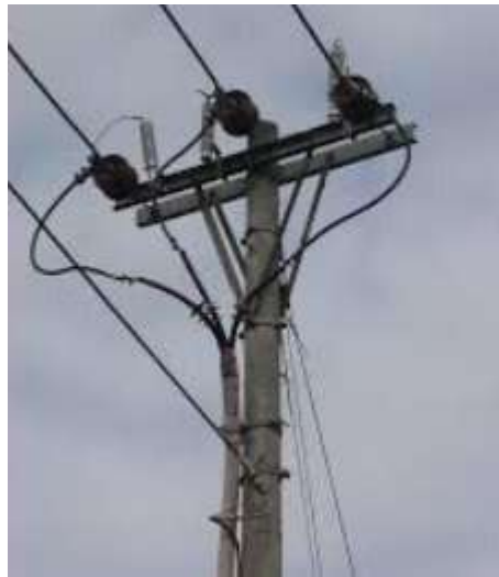
Gambar 2. 5 Saluran Udara tegangan Menengah
