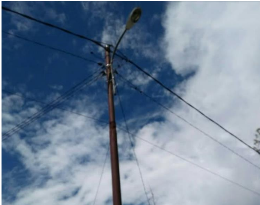
Gambar 2. 19 Saluran Udara Tegangan Rendah
