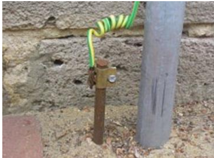
Gambar 2. 18 Grounding pada Gardu Distribusi
