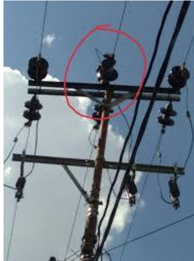
Gambar 2.19 Gangguan Pada SUTM Akibat Isolator Retak Atau Pecah
