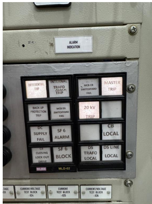
Gambar 3.12 Indikasi Alarm Pada Panel Proteksi gangguan kedua
