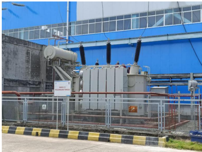
Gambar 2.1 Transformator Daya Gardu Induk Mintin
