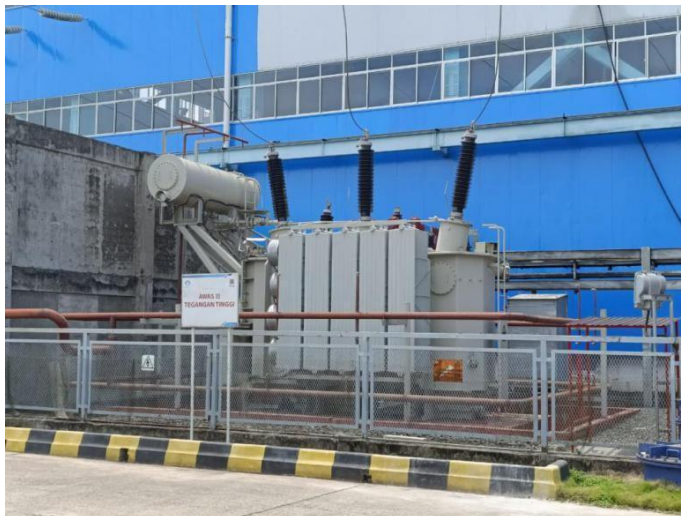
Gambar 2.1 Transformator Daya Gardu Induk Mintin
