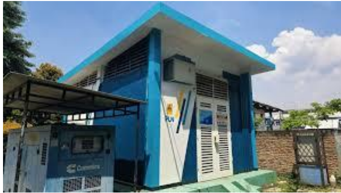
Gambar 2.14. Gardu beton (permanen)
