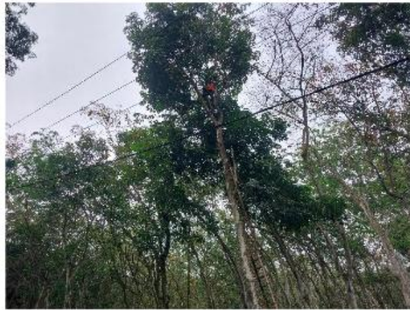
Gambar 2. 2 Saluran Udara Tegangan Menengah
