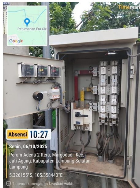
Gambar 2. 9. Panel Hubung Bagi Tegangan Rendah (PHB-TR)
