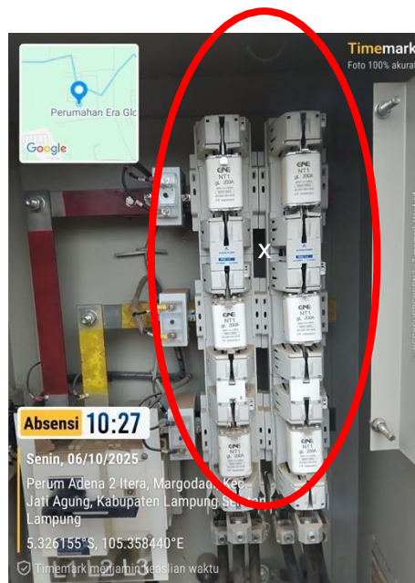
Gambar 2. 11. NH Fuse Sumber: Dokumentasi Pribadi
