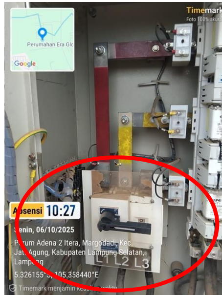
Gambar 2. 10. Saklar Utama Sumber: Dokumentasi Pribadi
