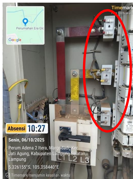
Gambar 2. 14. Current Transformer Sumber: Dokumentasi Pribadi
