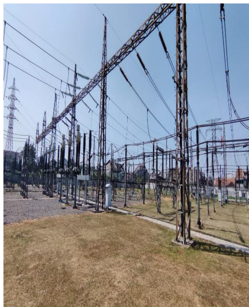
Gambar 2.2 Gardu Induk 150kV
