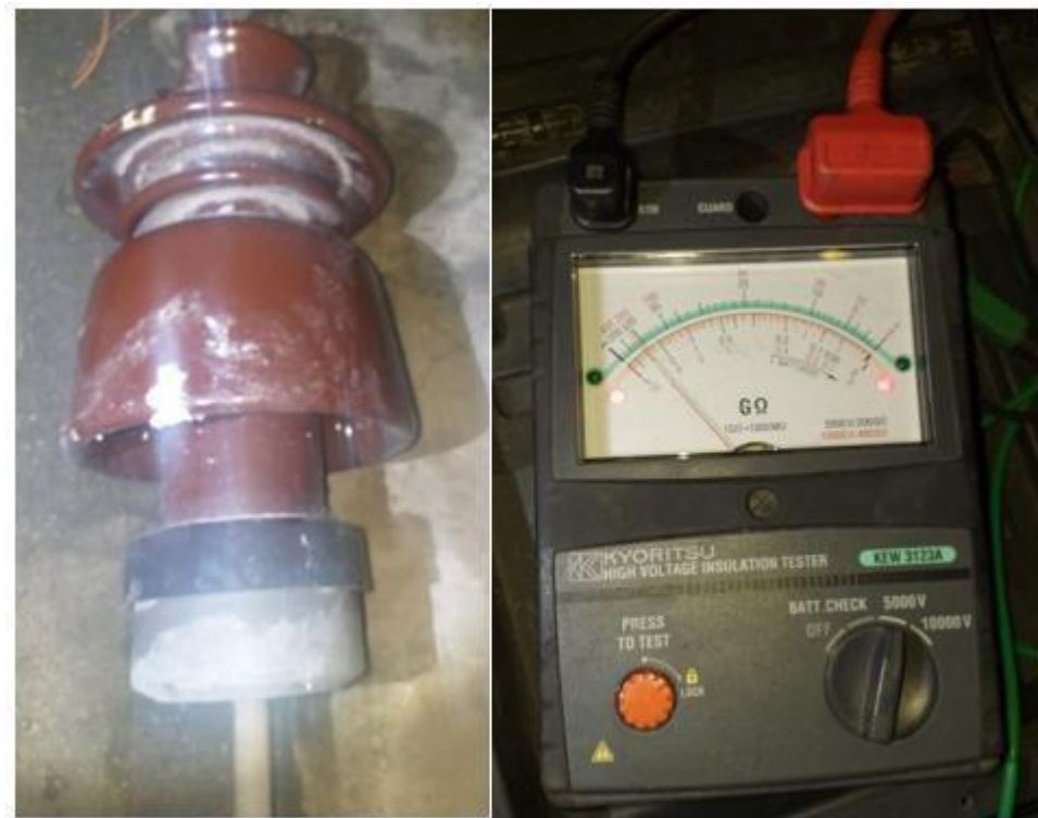
Gambar 4.3 Kondisi Isolator Post Rusak dan Hasil Pengukuran Tahanan Isolasi Sebelum Penggantian
