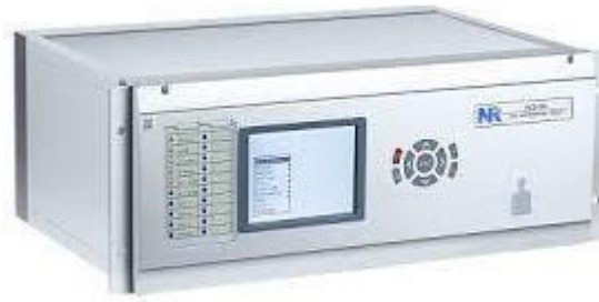
Gambar 2. 4 Relay PCS-931 yang terpasang pada panel proteksi GI Sandai
