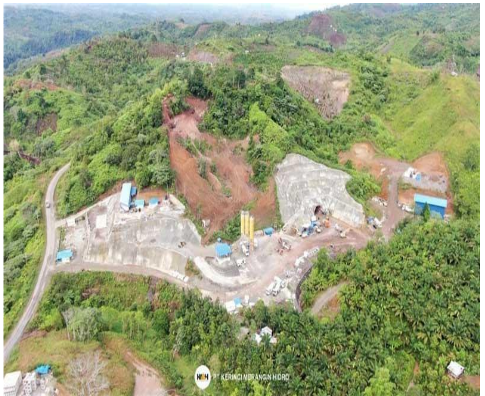
Gambar 1.1 Foto Udara PLTA Kerinci Merangin Hidro
