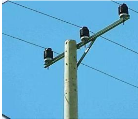
Gambar 2. 3 Saluran Udara Tegangan Menengah (SUTM)
