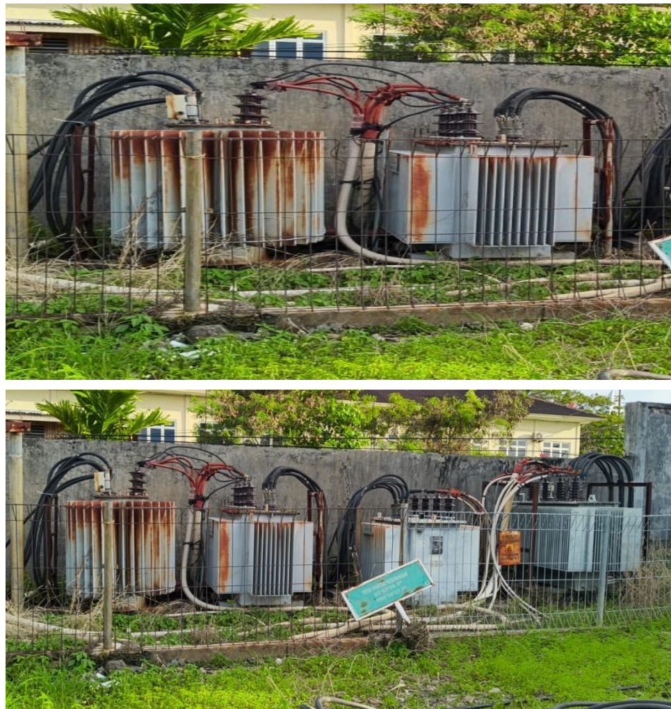
Gambar 2.12 Trafo Step UP
