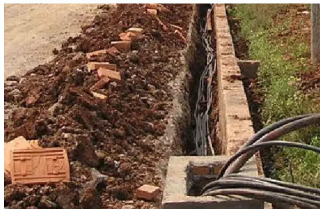
Gambar 2.16 Saluran Kabel Tegangan Rendah (SKTR)
