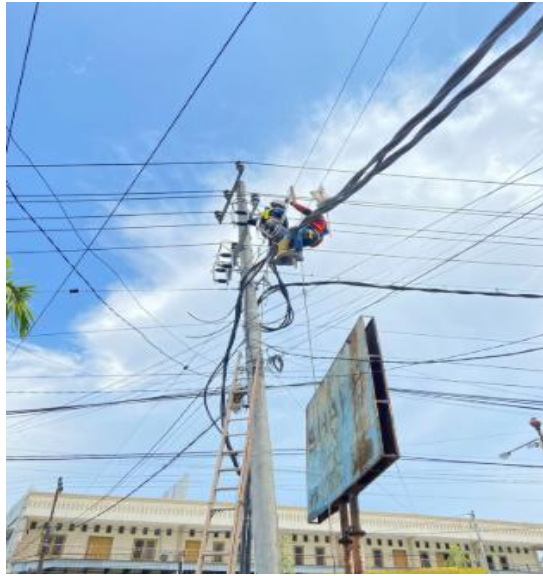
Gambar 2.9 Saluran Kabel Udara Tegangan Menengah (SKUTM) 20kV
