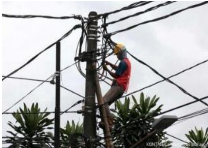
Gambar 2.15 Saluran Udara Tegangan Rendah (SUTR)
