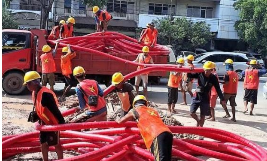
Gambar 2.7 Saluran Kabel Tegangan Menengah (SKTM) 20kV
