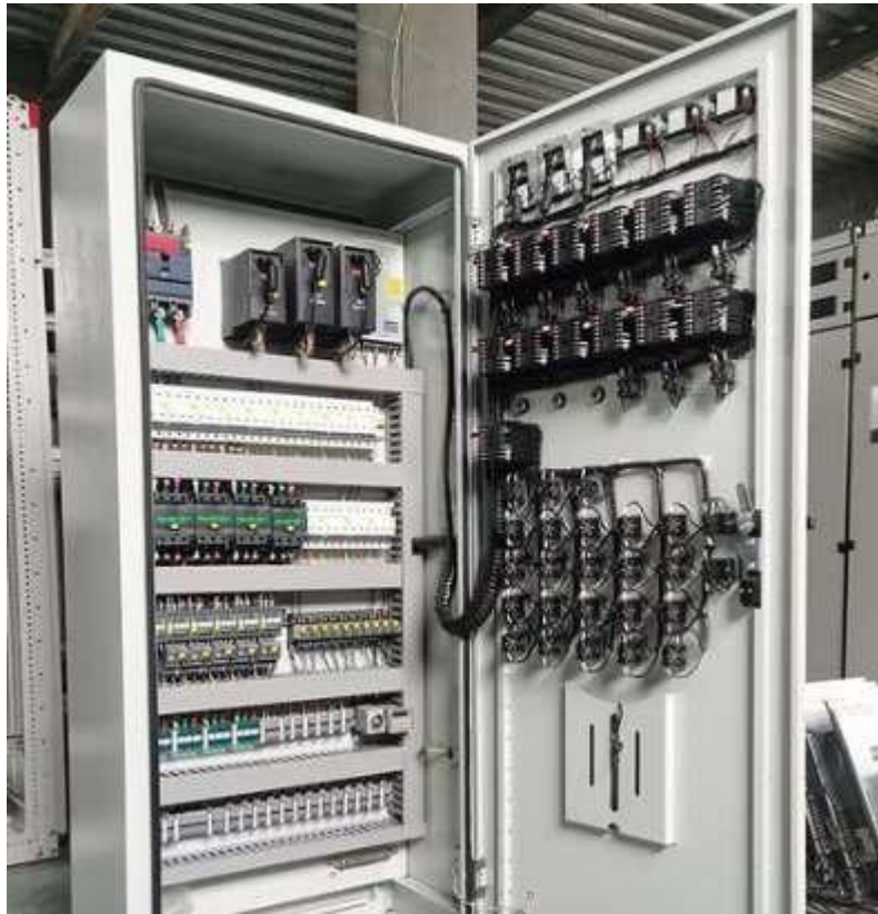
Gambar 2. 17 Panel Kontrol Perangkat Listrik
