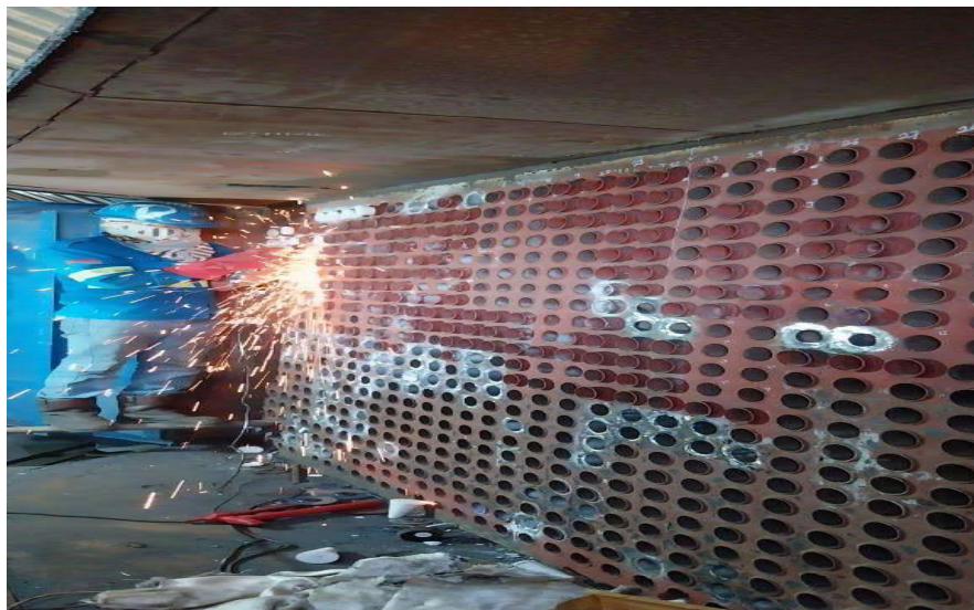
Gambar 2. 15 Pekerjaan Air Heater
