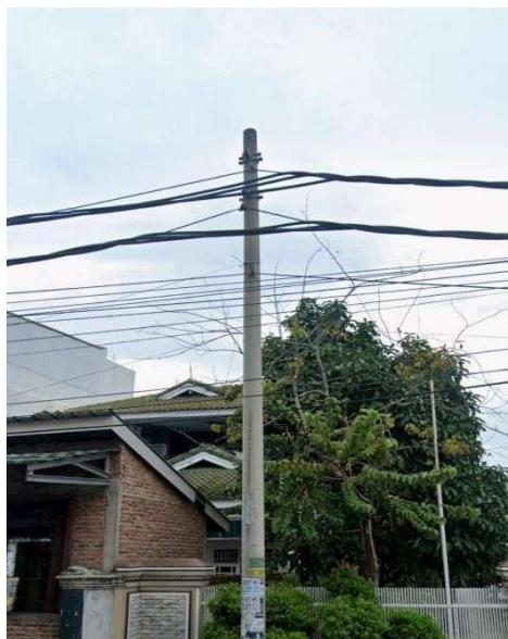
Gambar 2. 11 Saluran kabel udara tegangan menengah
