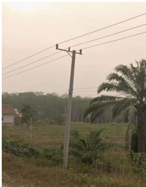
Gambar 2. 10 Saluran udara tegangan Menengah
