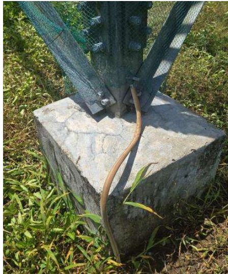
Gambar 2. 18 Grounding pada SUTT
