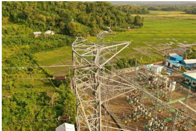
Gambar 2. 13 GSW dan OPGW Sumber: Dokumentasi Pribadi
