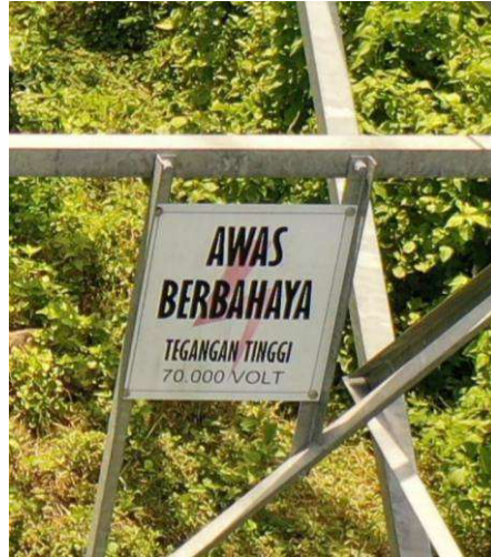
Gambar 2. 9 Danger Plate Sumber: Dokumentasi Pribadi
